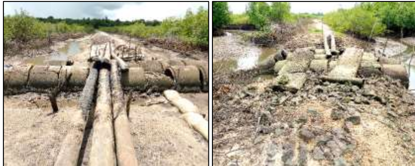
Photo 3 : État des ouvrages de franchissement sur la route régionale 14.0 à Essoukoudiack
